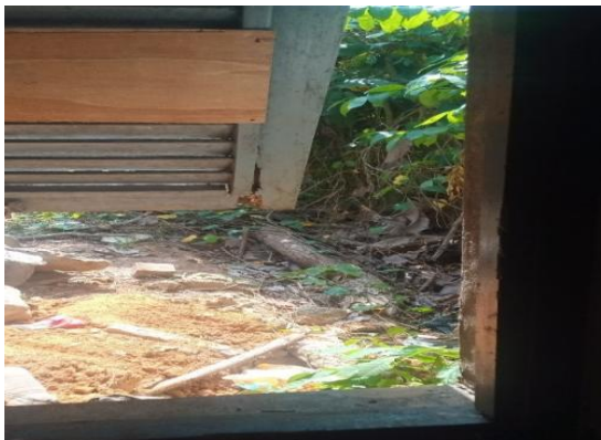
Photo 1 : Adjin, vue d'une fenêtre forcée lors d'un vol par effraction dans une cour commune Cliché : Coulibaly Adama
