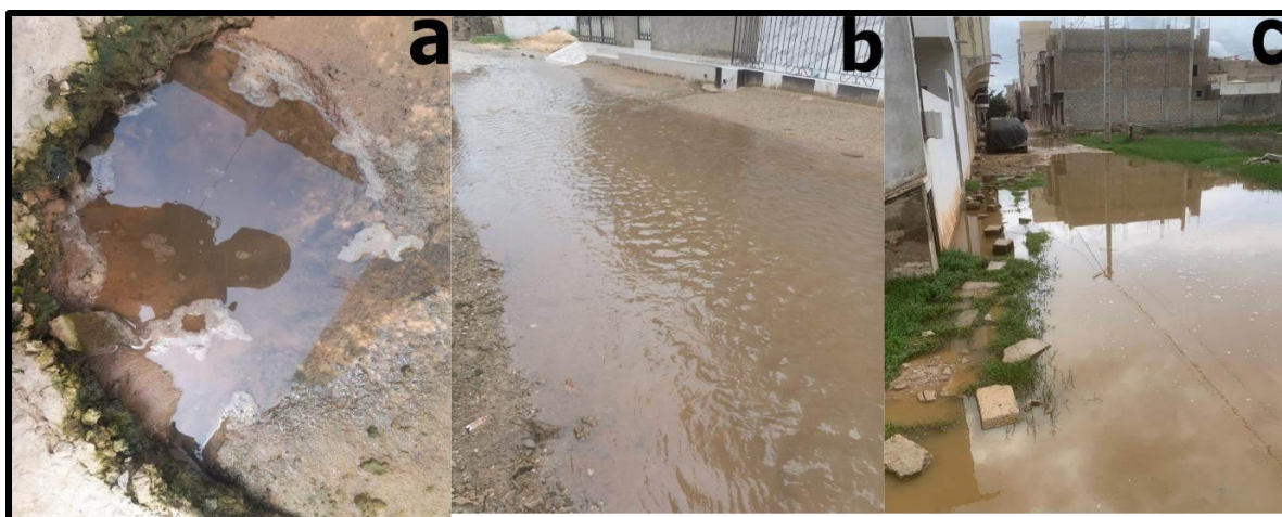
Planche 1 : Sources du phénomène d'humidité : a) Nappe souterraine ; b) Eaux de ruissellement ; c) Eaux stagnantes (S. SY, août-septembre 2023)
