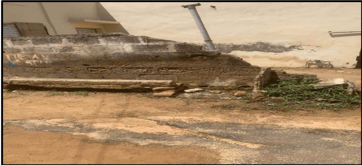
Photo 2 : Effondrement d'une partie d'un mur extérieur (S. SY, septembre 2023)
