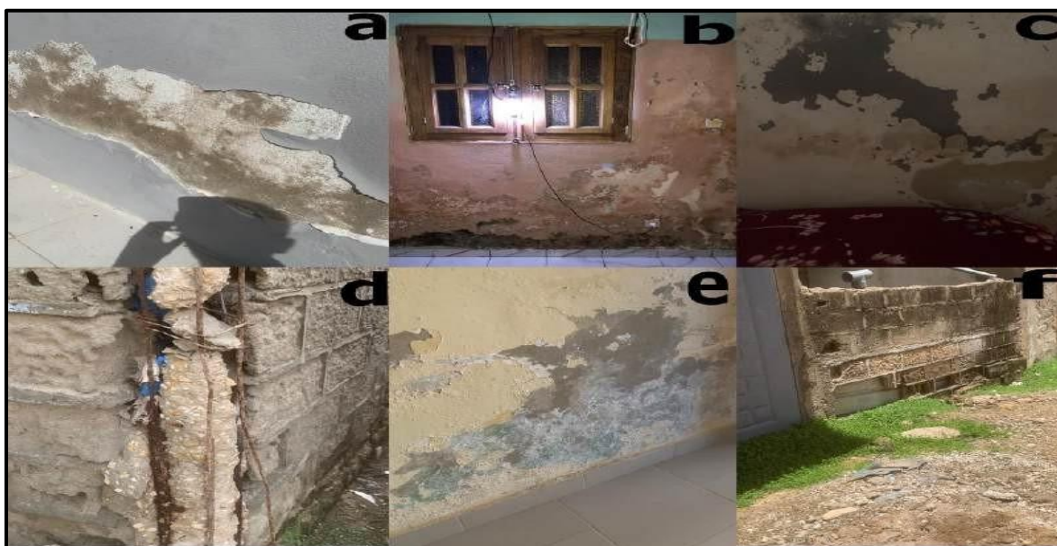
Planche 2 : Symptômes de l'humidité ascensionnelle : a) Ecaillage de la peinture, b) Mouillure des murs, c) Tâche d'humidité, d) Corrosion des métaux, e) Salpêtre, f) Pourriture des briques (S. SY, juillet-septembre 2023)
