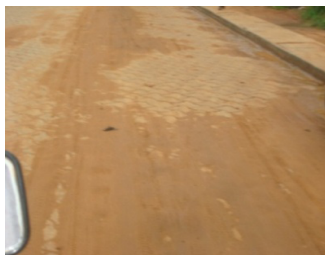
Photo 3 : Voie pavée de Kpota ensablée
