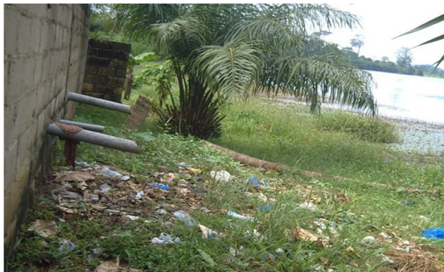
4A : Conduites d'eaux usées dans le lac
