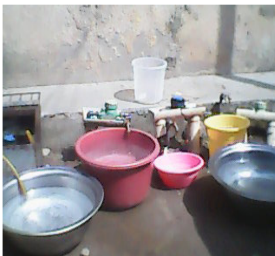
Photo 8 : Approvisionnement en eau à partir de robinets installés près des compteurs à Abobo-sud 2 e Tranche
